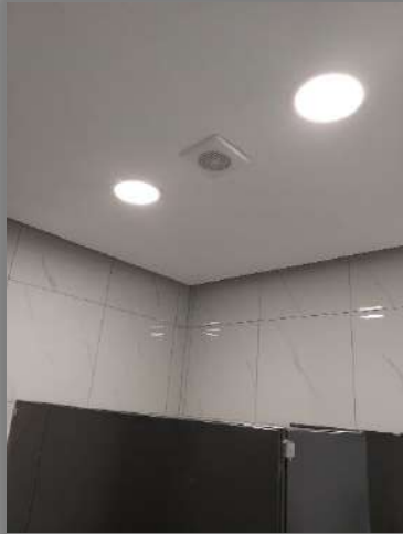
EXTRACTOR DE AIRE
