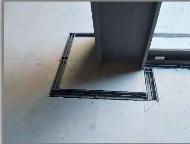
REJILLA METALICA PLUVIAL
