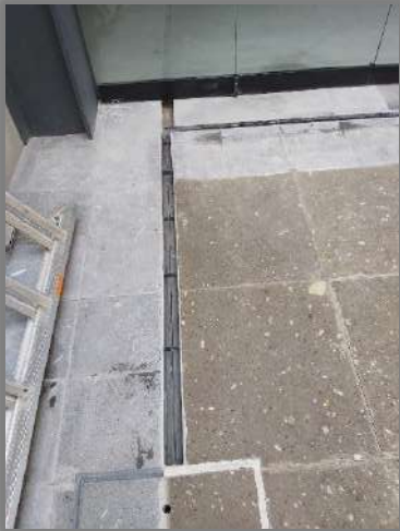
REJILLA METALICA PLUVIAL
