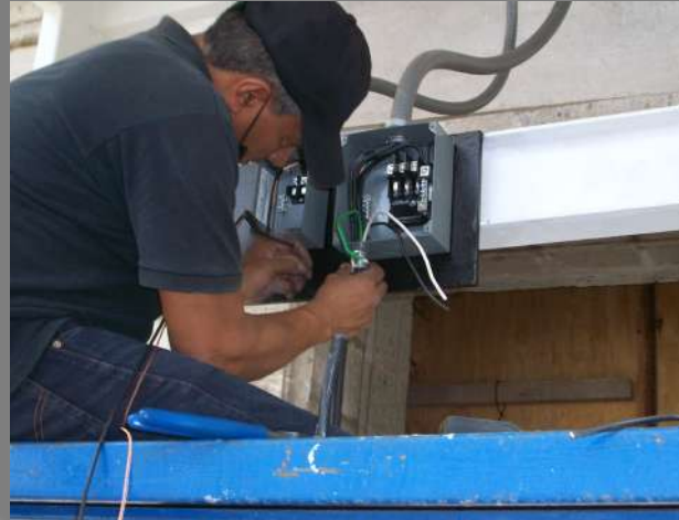
INTEGRACION DE INTERRUPTORES
